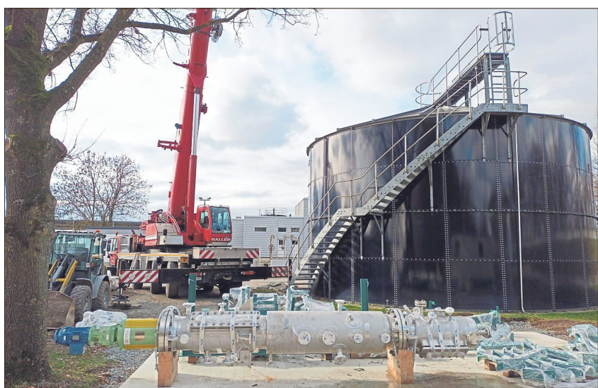
Das Kernstück der Biomethan-Pilotanlage neben dem Straubinger Klärwerk: der Bioreaktor (vorne). Das Bild entstand vor etwa einem Jahr bei der Anlieferung der Anlagenteile. Archivfoto: Anna Rieser
